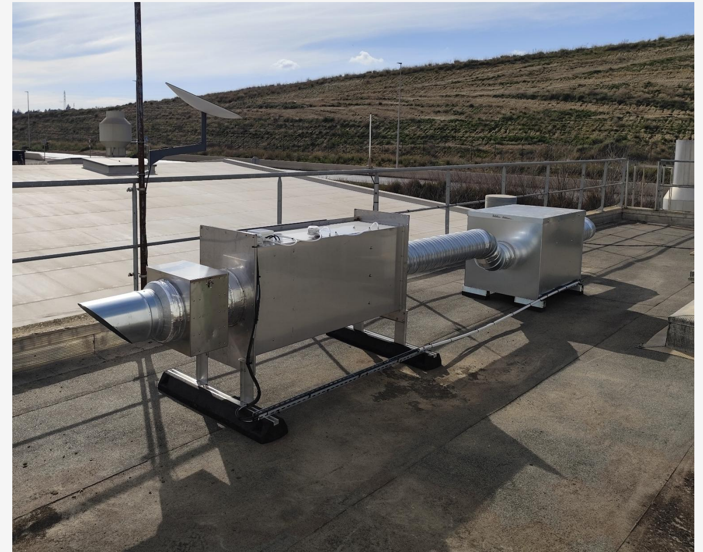
Exemple d'installation pilote
